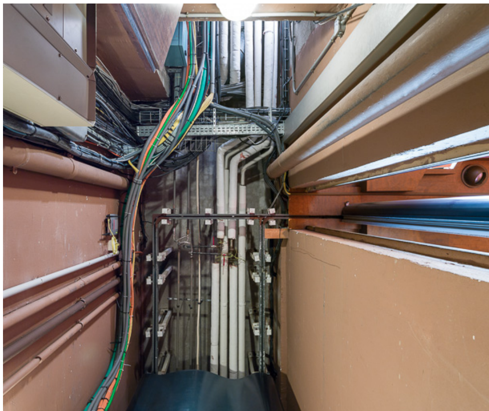
Salle des Assemblées : vue du système de rails pour faire coulisser manuellement la cloison. 21, Dijon
