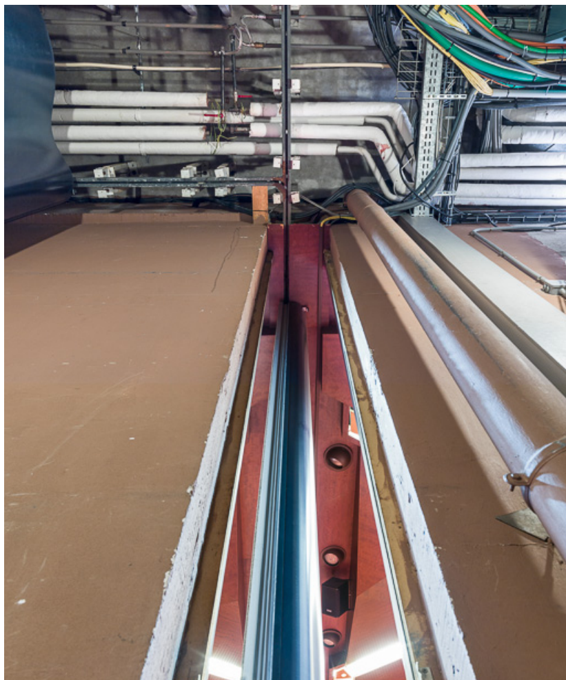
Salle des Assemblées : vue du système de rails pour faire coulisser manuellement la cloison. 21, Dijon
