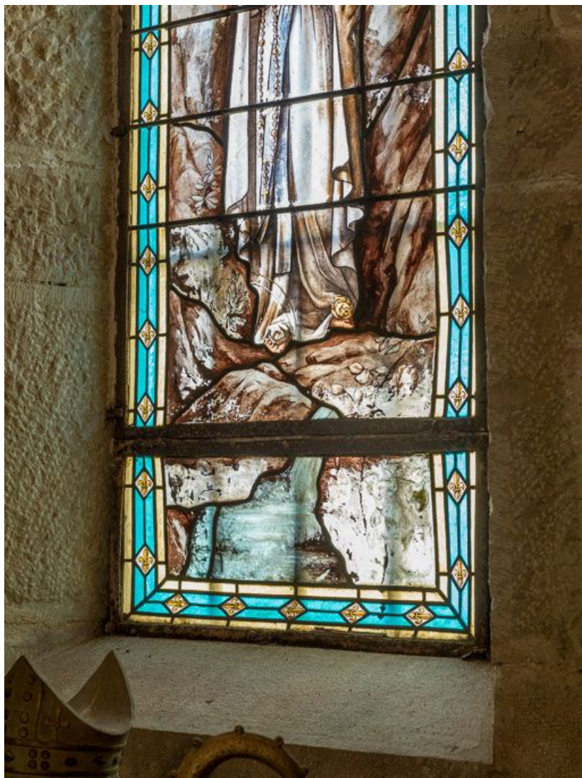
Vitrail : détail de la déformation et de l'altération des couleurs. 21, Pernand-Vergelesses
