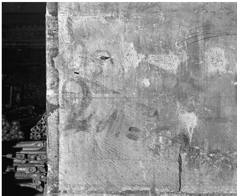
Choeur, mur nord : graffiti.
