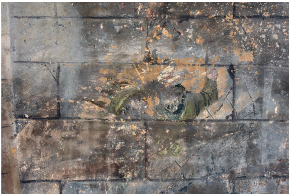
Sondage entre les deux croix de droite, révélant deux personnages.
