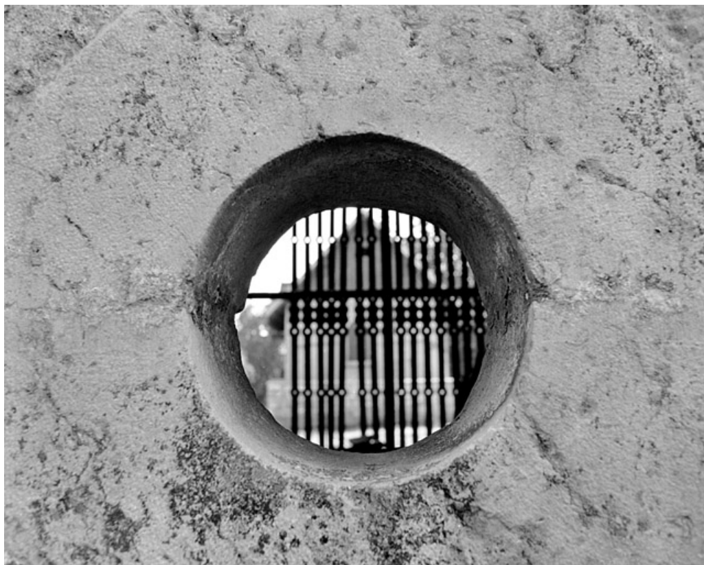
L'orangerie en 1981. Détail d'une baie d'aération. SRI. Enquête régionale sur les bâtiments industriels (1979-1981). 90, Beaucourt rue Sous les Vignes
