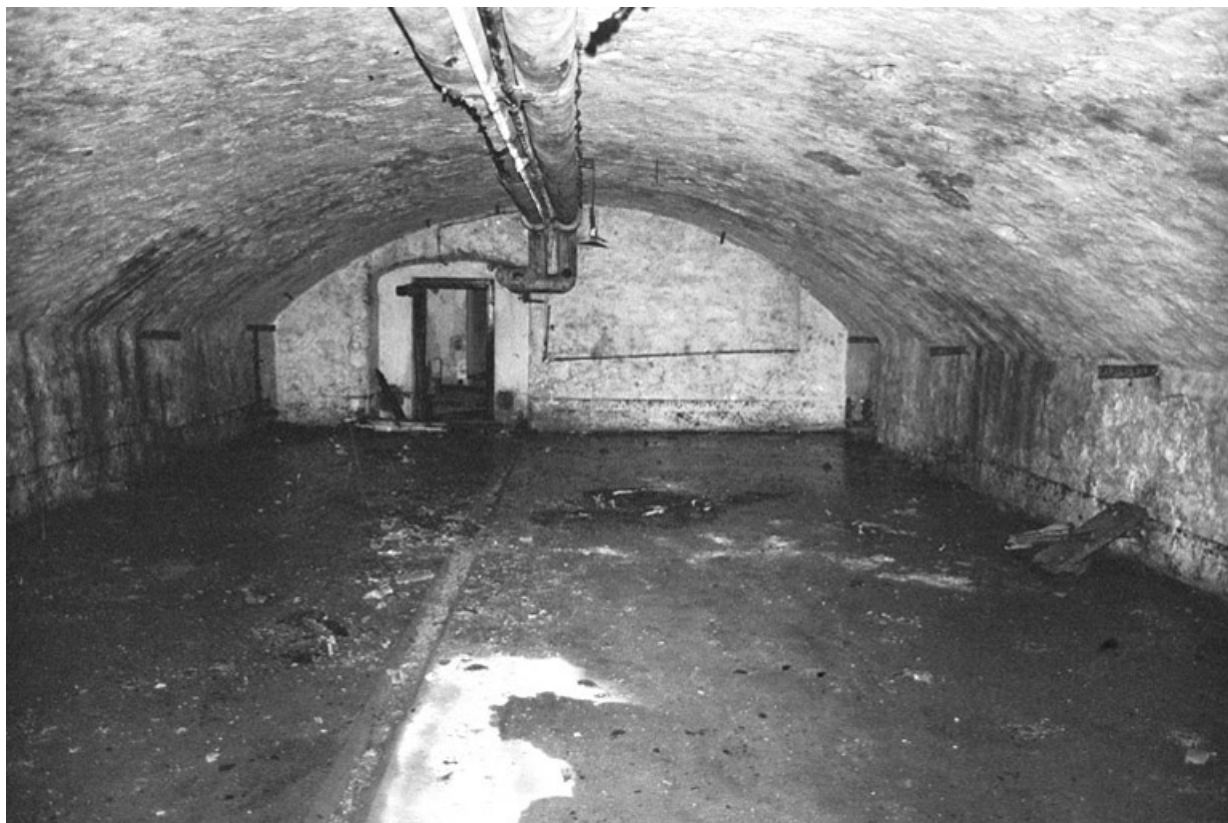
Cave en 1980. SRI. Enquête régionale sur les bâtiments industriels (1979-1981). 90, Lachapelle-sous-Rougemont, 4, 6 rue du Général de Gaulle
