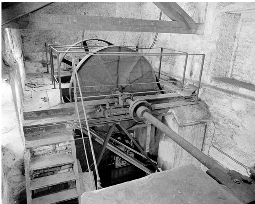
Système de transmissions de la turbine Kaplan.
