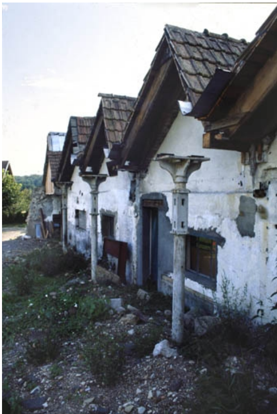
Détail du mur et des poteaux de fonte marquant la limite de destruction de l'atelier de fabrication. 90, Auxelles-Bas rue de la Paix
