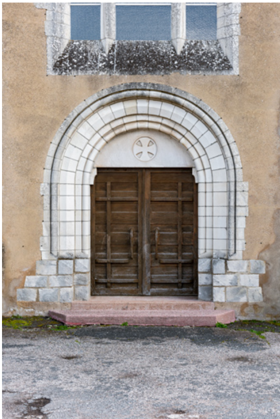
Détail de la baie à arc en plein cintre de la façade antérieure et sa porte en bois. 89, Montacher-Villegardin, 8 Grande Rue
