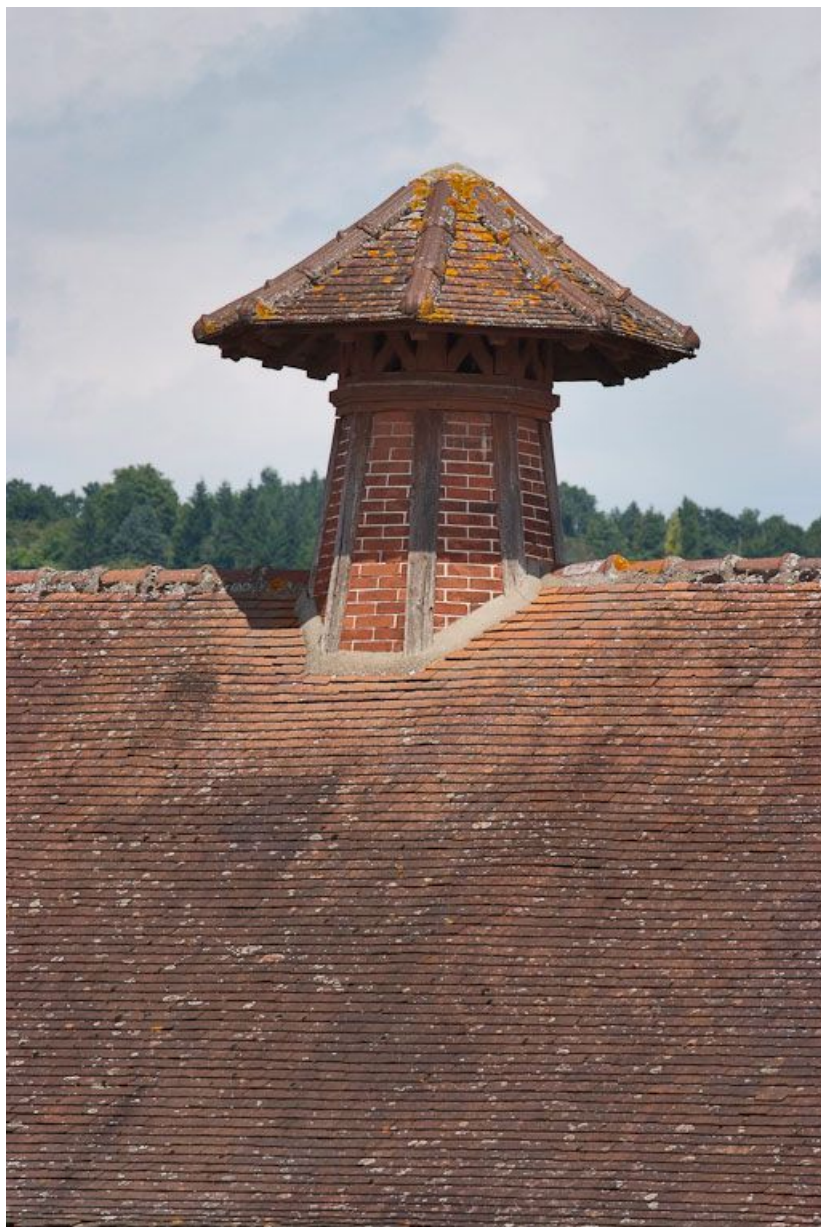
Bâtiment à droite de l'entrée de la cour : détail de la 1ère souche de cheminée de ventilation. 89, Joigny quai de l'Hôpital
