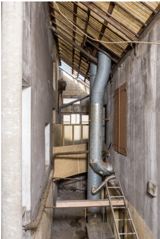
Cour couverte entre le café (à gauche) et le troisième corps de bâtiment (à droite), à usage de bureaux. 71, Montceau-les-Mines, 13 rue Ferrer
