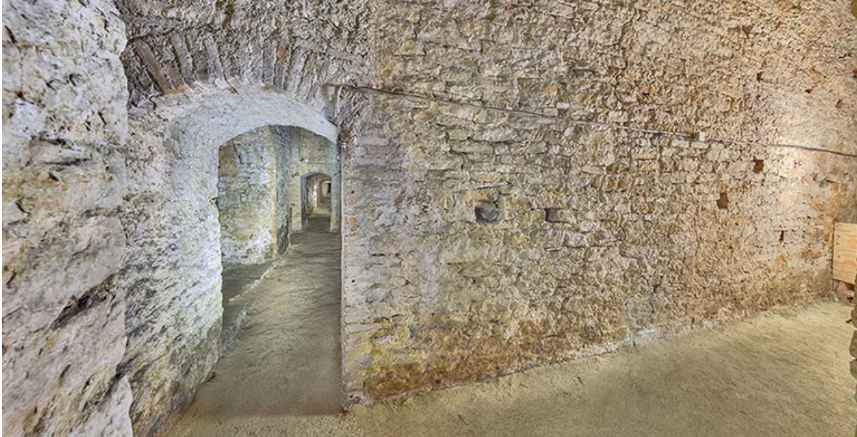
La galerie au niveau de l'angle du flanc et de la face.
