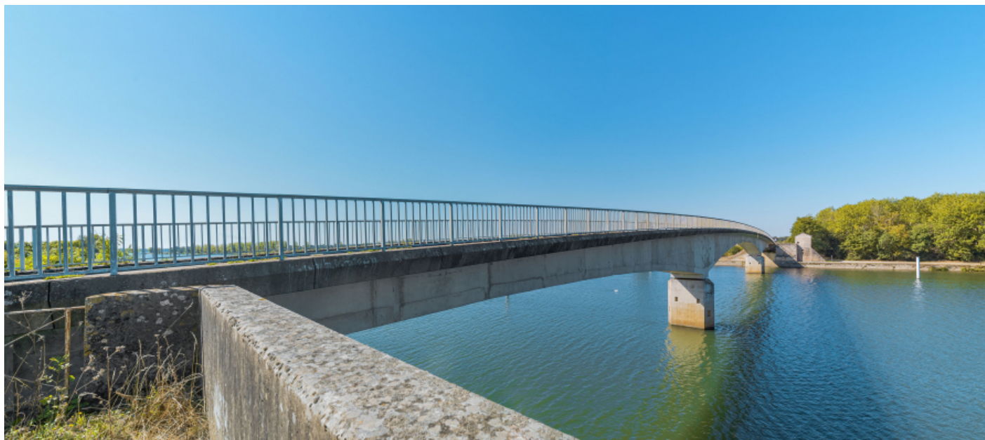
Vue d'ensemble du pont de Thorey depuis la culée de la rive gauche.
