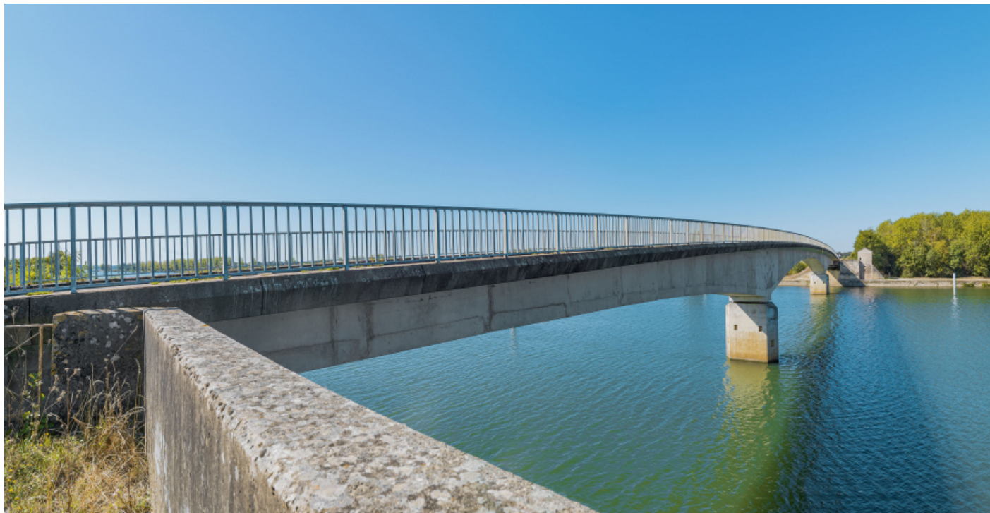
Vue d'ensemble du pont de Thorey depuis la culée de la rive gauche.
