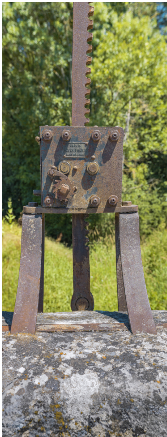
Détail de la plaque indiquant la provenance des vannes.
