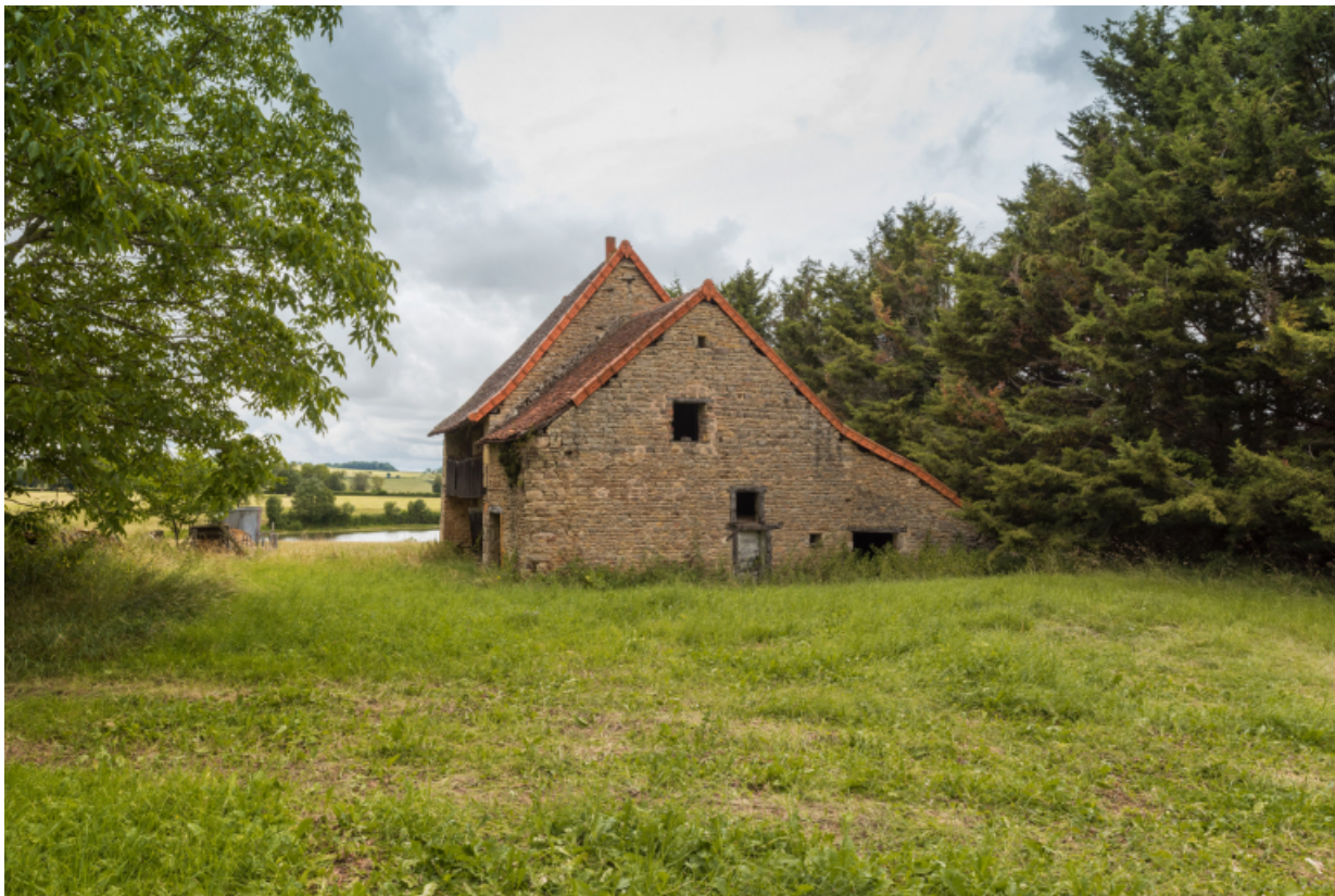
vue de la ferme depuis le nord-est, et du mur-pignon de la dépendance construite contre la maison au XIXe siècle et abritant une étable surmontée d'un fenil.
