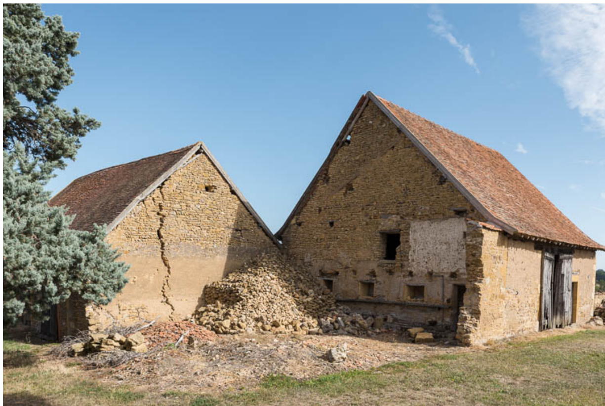
Vue des deux ailes de dépendances. A la jonction des deux bâtiments, une ancienne étable à bovins a été démolie suite à l'effondrement de sa charpente..
