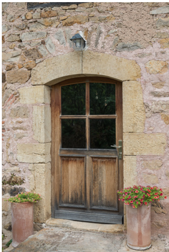
Porte d'entrée de la maison, couverte d'un arc segmentaire 71, Colombier-en-Brionnais, 55 route de Frâgne, lieudit : Frâgne
