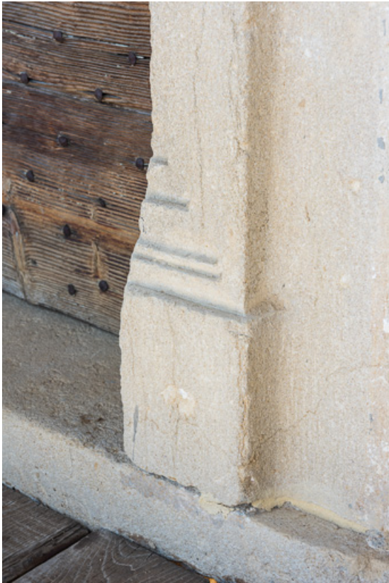
Détail d'une baie moulurée du XVIIe siècle, à l'étage de la maison 71, Vauban, lieudit : la Place
