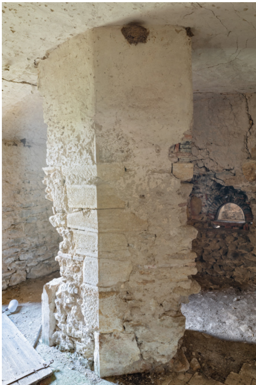
Reste de maçonnerie, dans la pièce à l'arrière du fournil (mur de la chambre du four ?)
