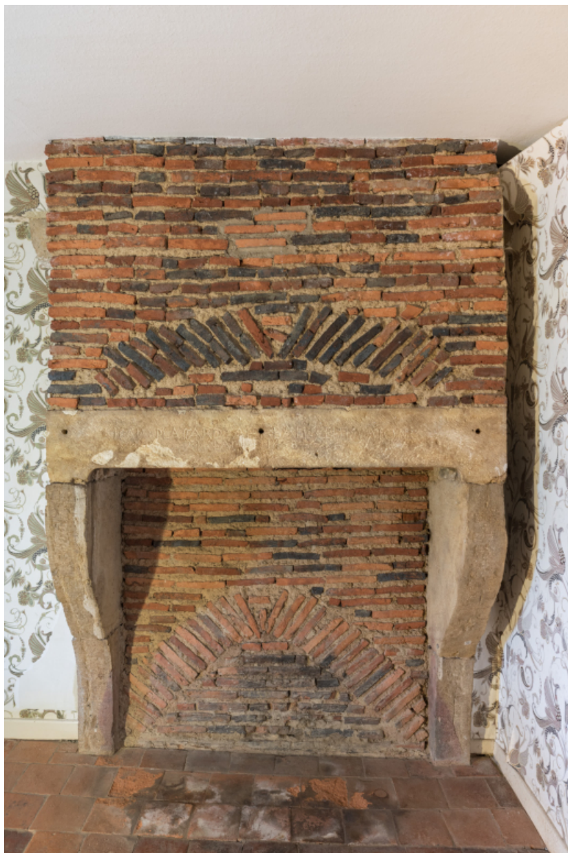
Vue de face de la cheminée de l'étage. inscription et date portée -1438- sur le couverture. 71, Amanzé, lieudit : La Grange Plassard
