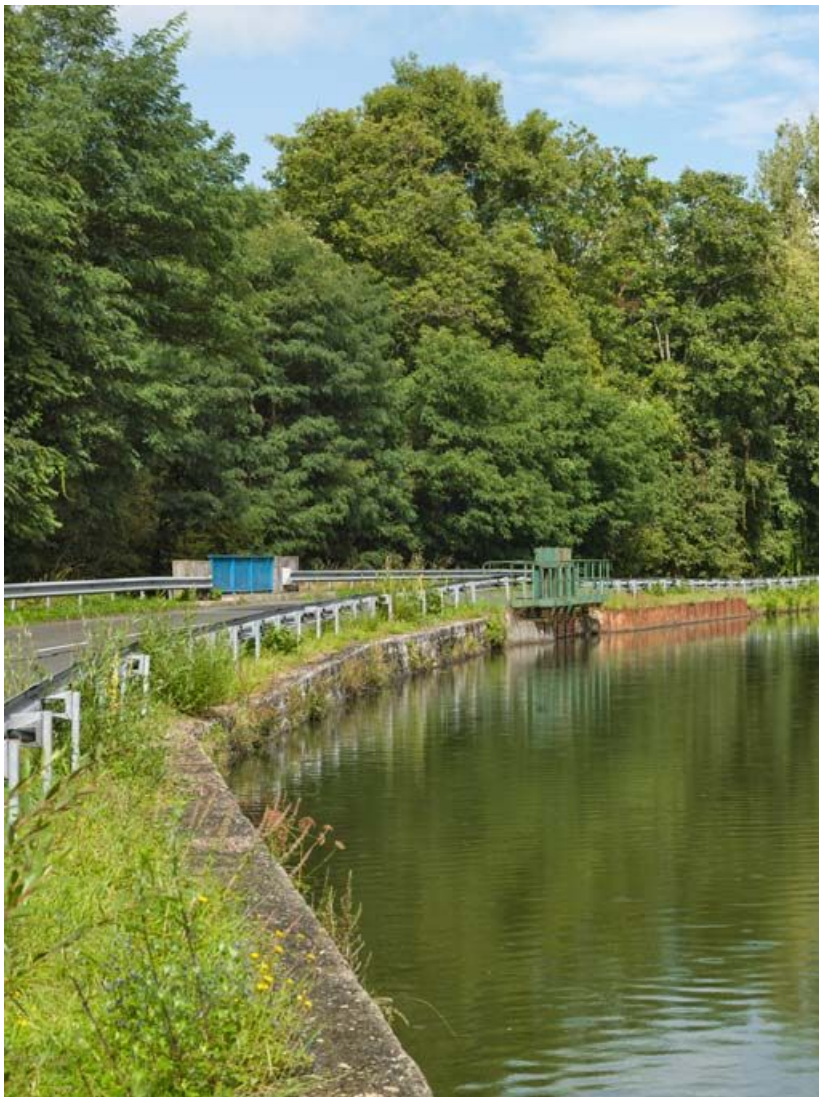
Vue de l'aqueduc et du déversoir à trois vannes. 71, Gévelard, lieudit : bief 15 du versant Loire-Océan
