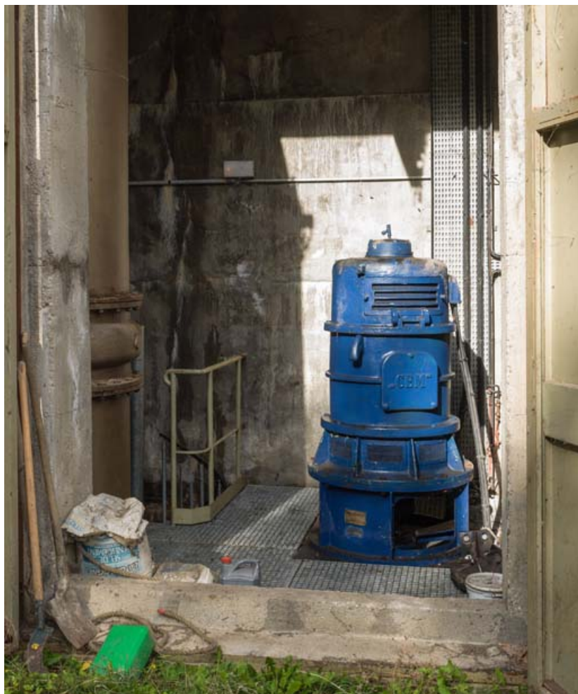
Détail de la station de pompage.
