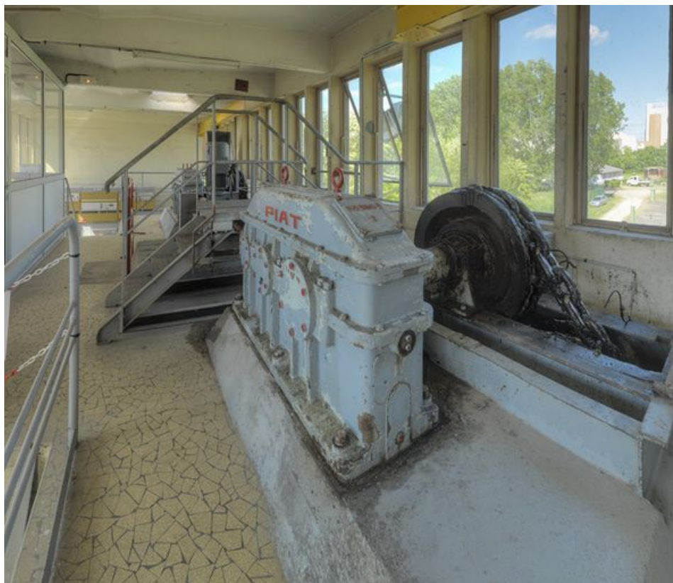
Vue intérieure de l'ancien poste de commande avec ses installations.
