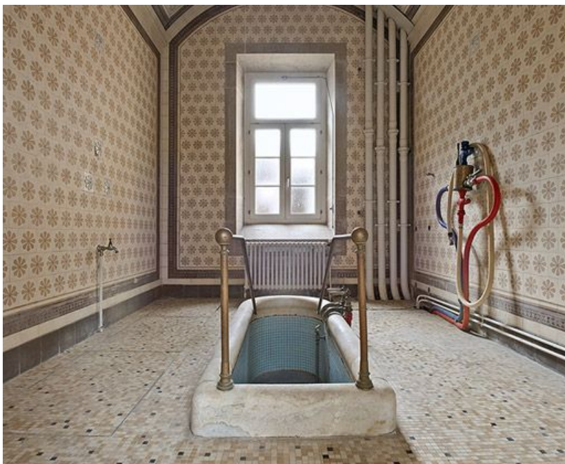
Salle de bain de l'angle de l'aile droite et du corps central.
