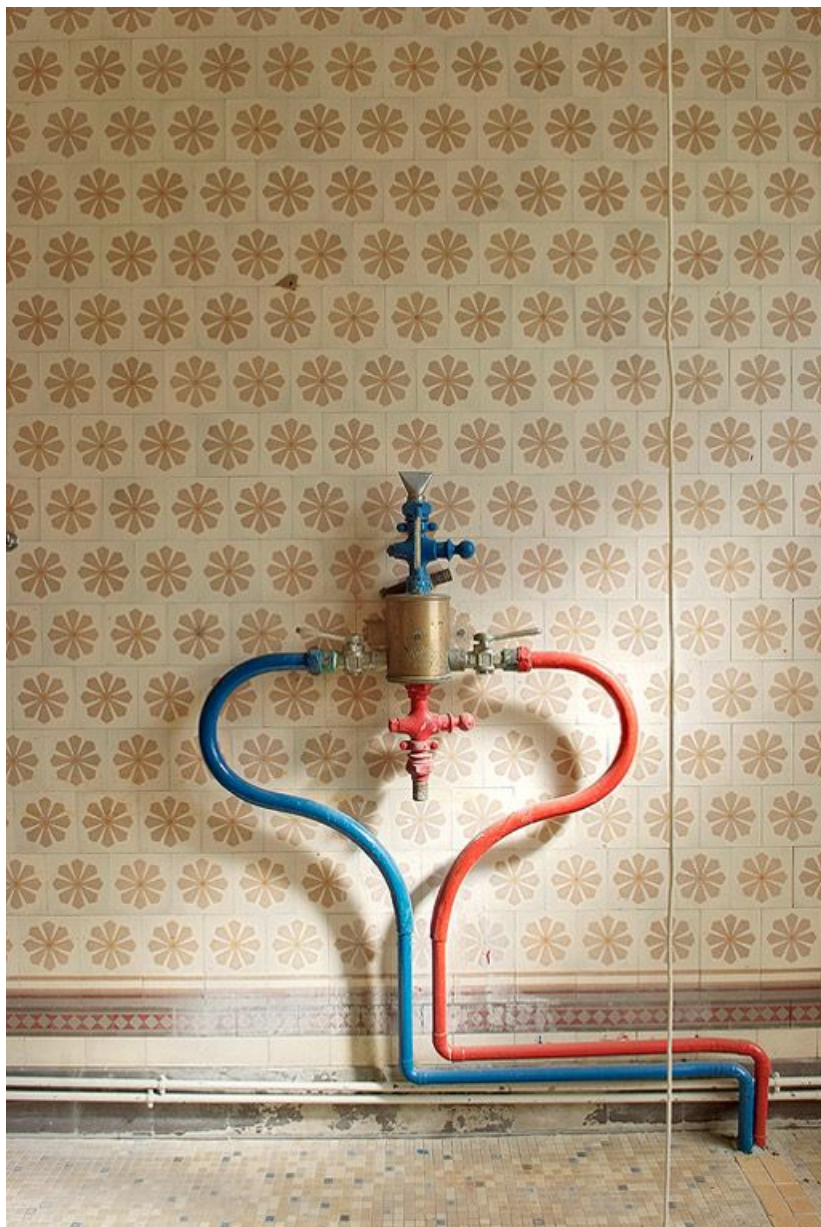
Corps central, salle de bain à droite du couloir du cabinet du médecin : détail du mitigeur. 71, Bourbon-Lancy rue de la Chaumière
