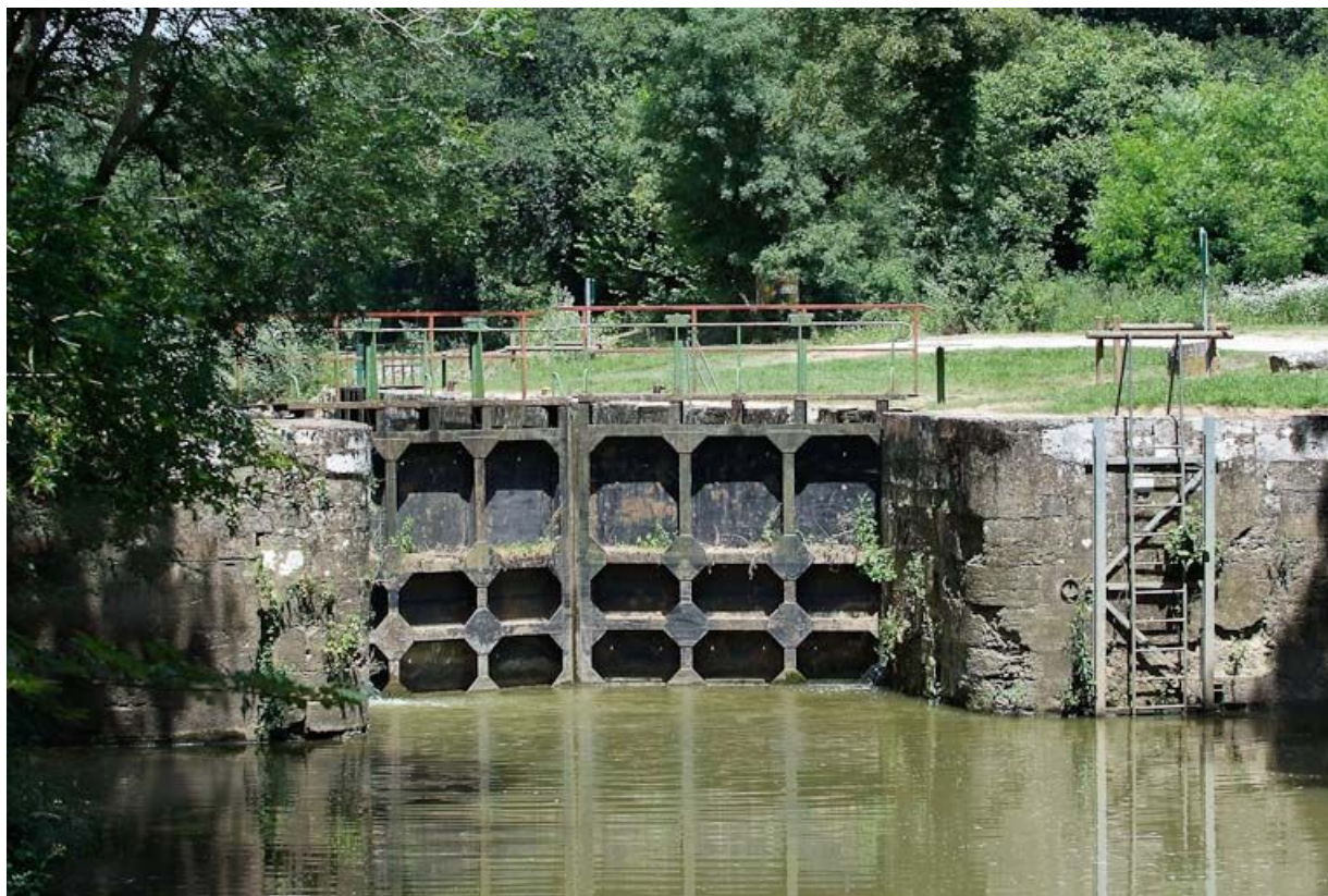
Tête aval du sas de l'écluse. Derrière, emplacement vide de la maison éclusière.
