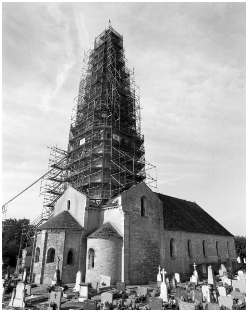
Vue prise du nord-est, pendant les travaux de réfection de la flèche.
