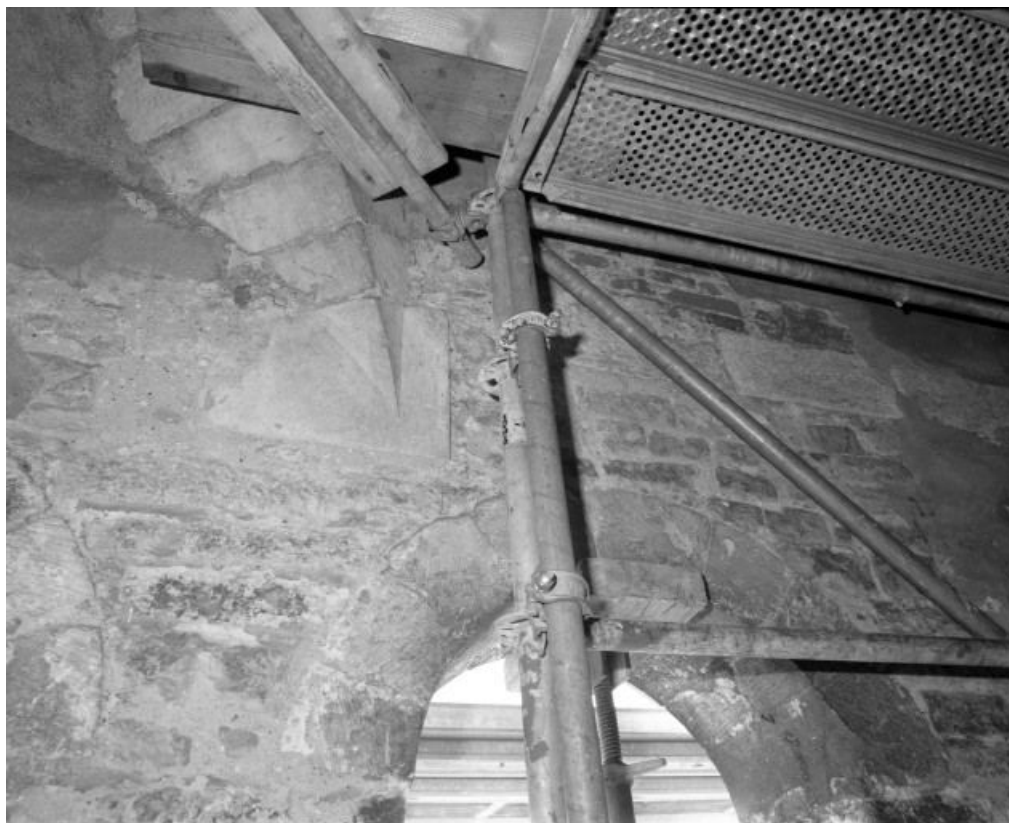
Clocher : support dans l'angle sud-est (vue prise pendant les travaux). 71, Ciel C.D. 72
