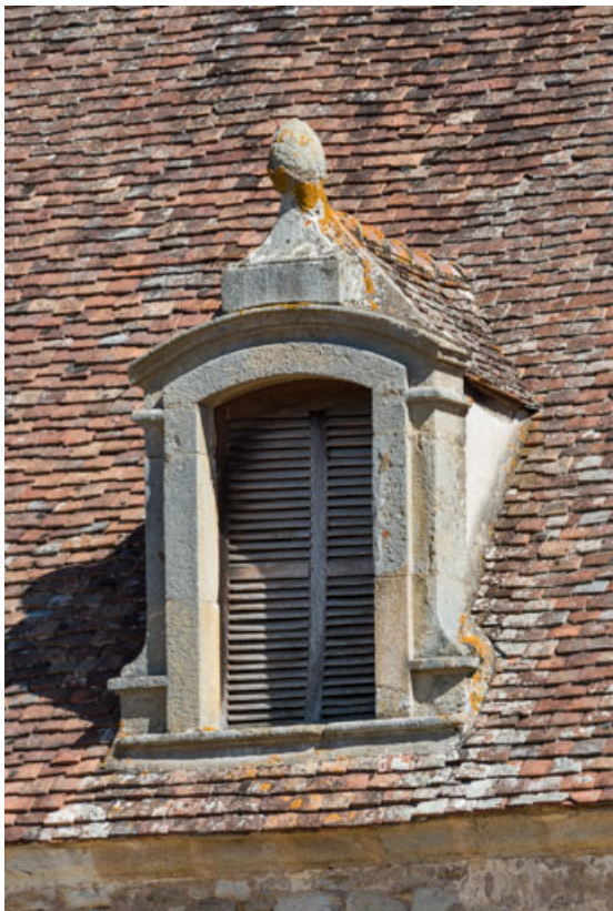
Façade antérieure : lucarne avec motif d'amortissement en pomme de pin. 71, Sully, 4 rue du Château
