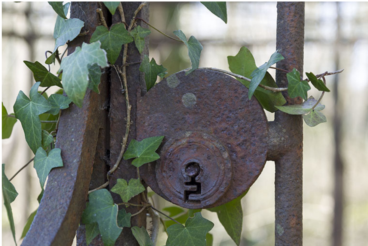
Serrure du garde-corps. 70, Savoyeux
