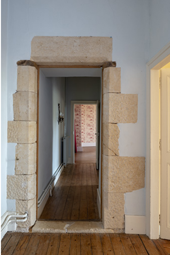
Premier étage du corps principal, porte séparant les deux parties constitutives (vue vers l'est). 70, Scey-sur-Saône-et-Saint-Albin, 8-10 rue de l' Enfer
