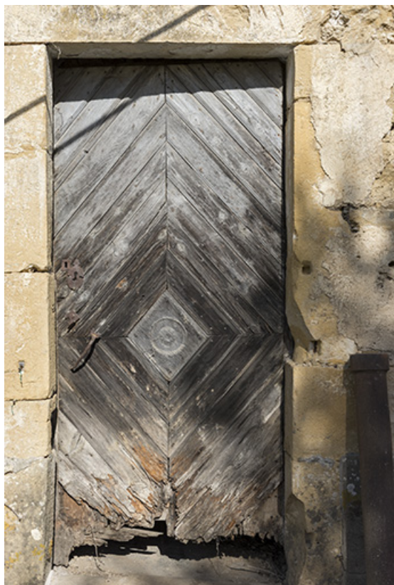
Porte piétonnière. Détail de menuiserie en losange. (bâtiment de gauche) 70, Betaucourt place du Petit-Magny
