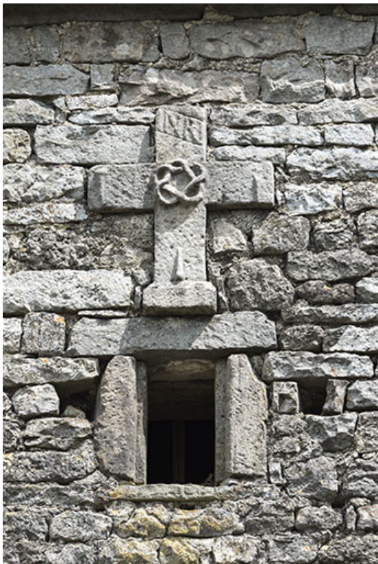
Détail de la croix sous la demi-croûpe du mur pignon 16 rue des Vosges. 70, Vouécourt
