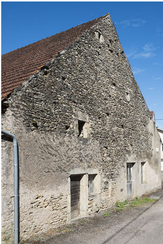
Mur pignon de la ferme située à l'angle de l'impasse du Château. 70, Ferrières-lès-Scey
