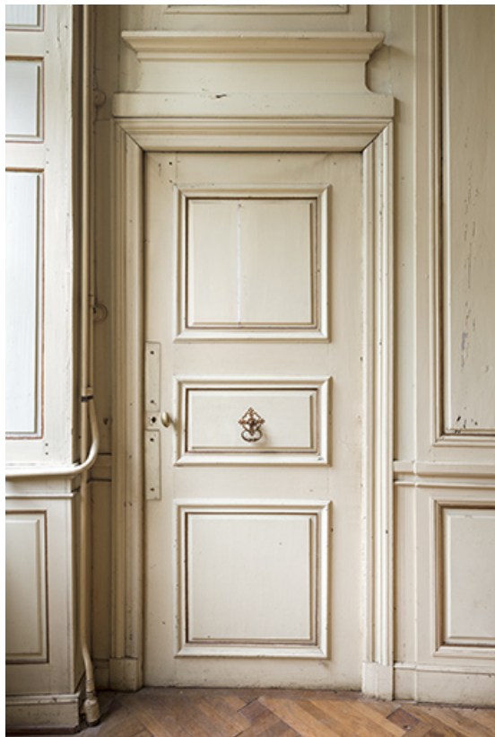
Rez-de-chaussée : première pièce à gauche de l'entrée. Détail de baie et lambris de revêtement. 70, Vouécourt, 1 rue des Marronniers
