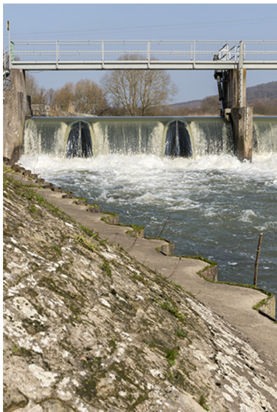
Vue de détail de la berge et du barrage depuis la rive droite en aval.
