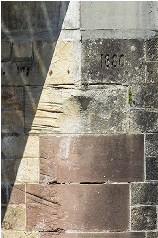
Détail des traces d'usure dans les maçonneries de l'écluse (aval) et date portée 1880. 70, Cendrecourt, lieudit : le Closey
