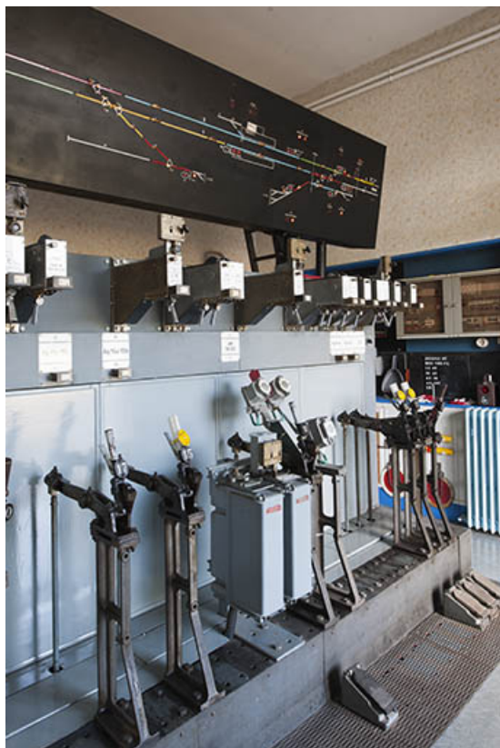
Gare de Port-d'Atelier : intérieur du poste d'aiguillage, de trois quarts. 70, Faverney
