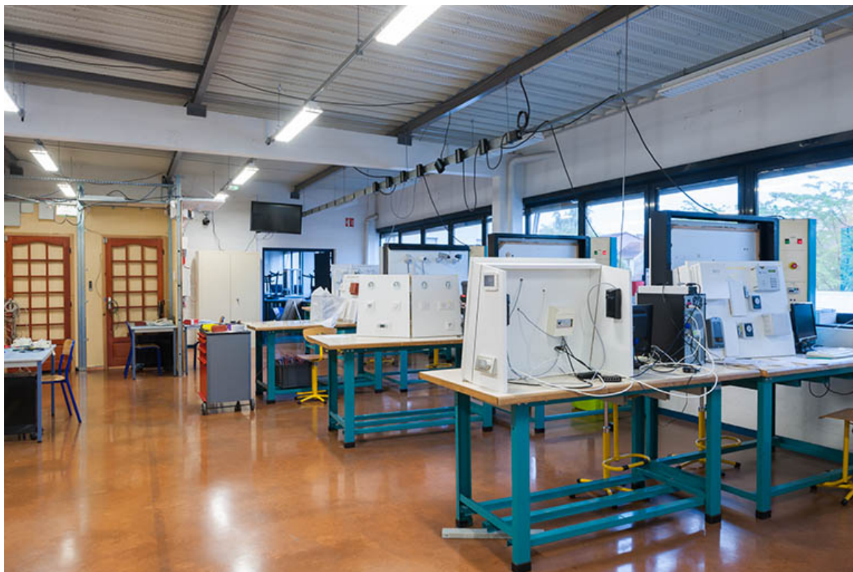
Dans l'atelier froid, climatisation et domotique.
