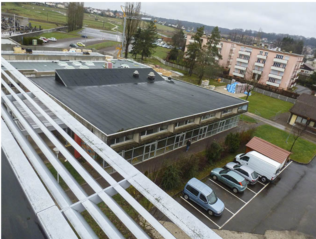
Depuis les toitures, vue sur la cantine (en 2012). 70, Lure, 1 rue Georges Colomb
