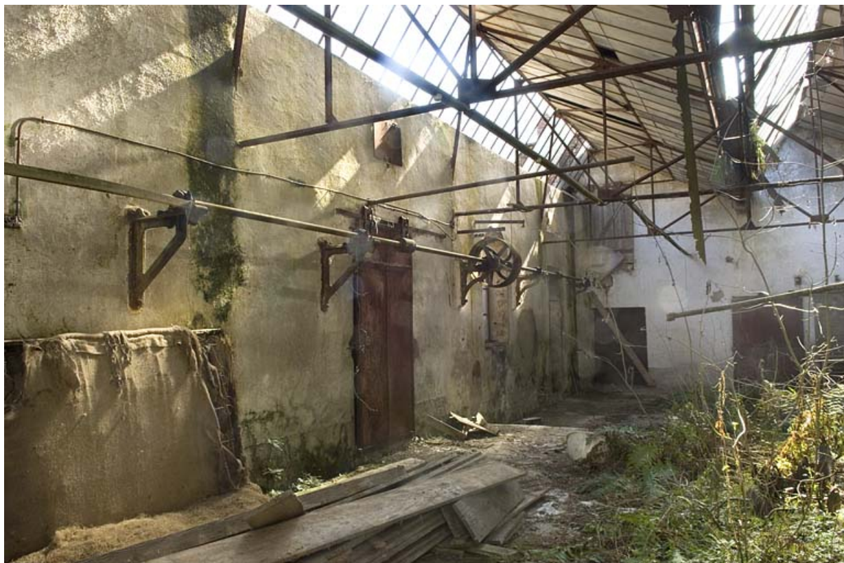
Atelier de fabrication. Charpente métallique et éléments de transmission. 70, Autet, lieudit : la Charme
