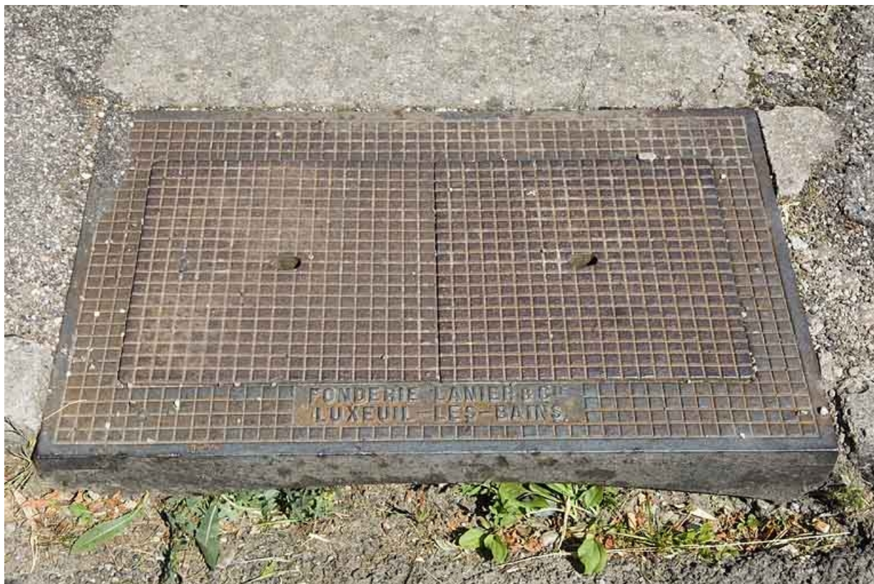
Plaque de voirie en fonte. (commune de Fougerolles).
