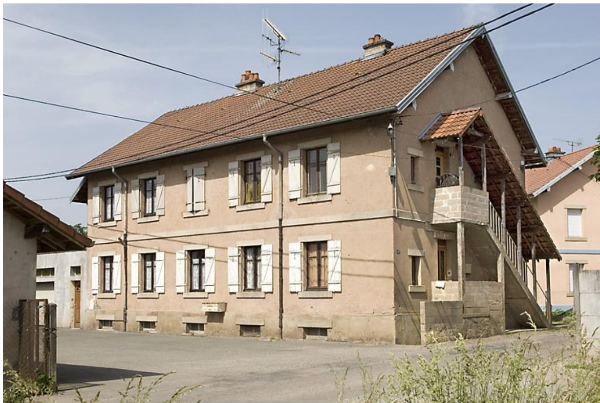
Logement ouvrier à 4 appartements (rue Jean Jaurès). 70, Saint-Sauveur, 44 rue du Maréchal Lyautey
