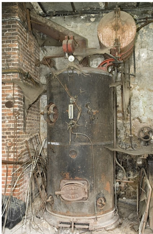
Atelier de distillation. Chaudière Egrot.
