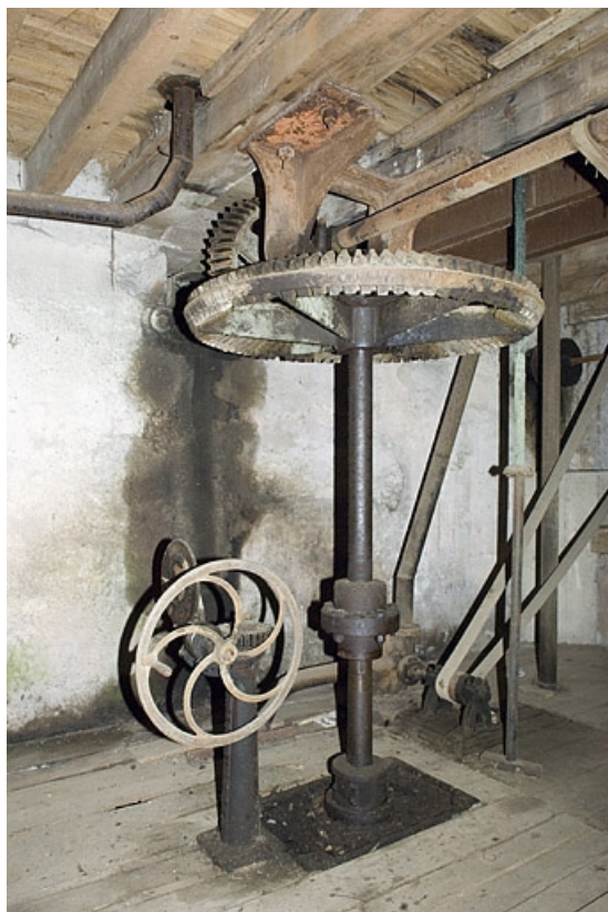
Système de transmission à l'aplomb de la turbine Goulut-Borne. Vue de côté. 70, Corbenay rue de la Féculerie, lieudit : les Naues
