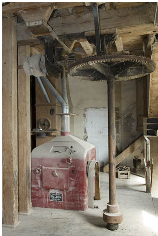
Convertisseur Ph. Lafon et arbre de transmission (1er étage).
