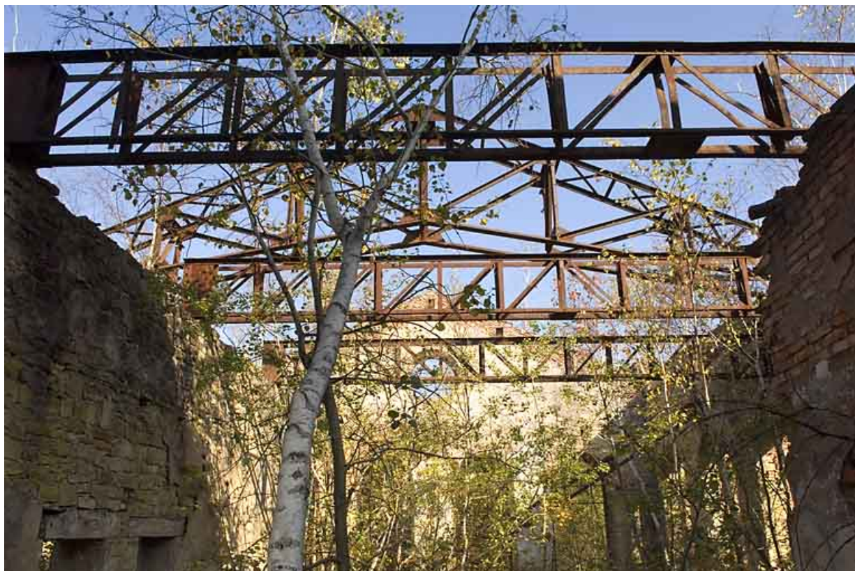
Bâtiment des bureaux et de la lampisterie : éléments de la charpente métallique.
