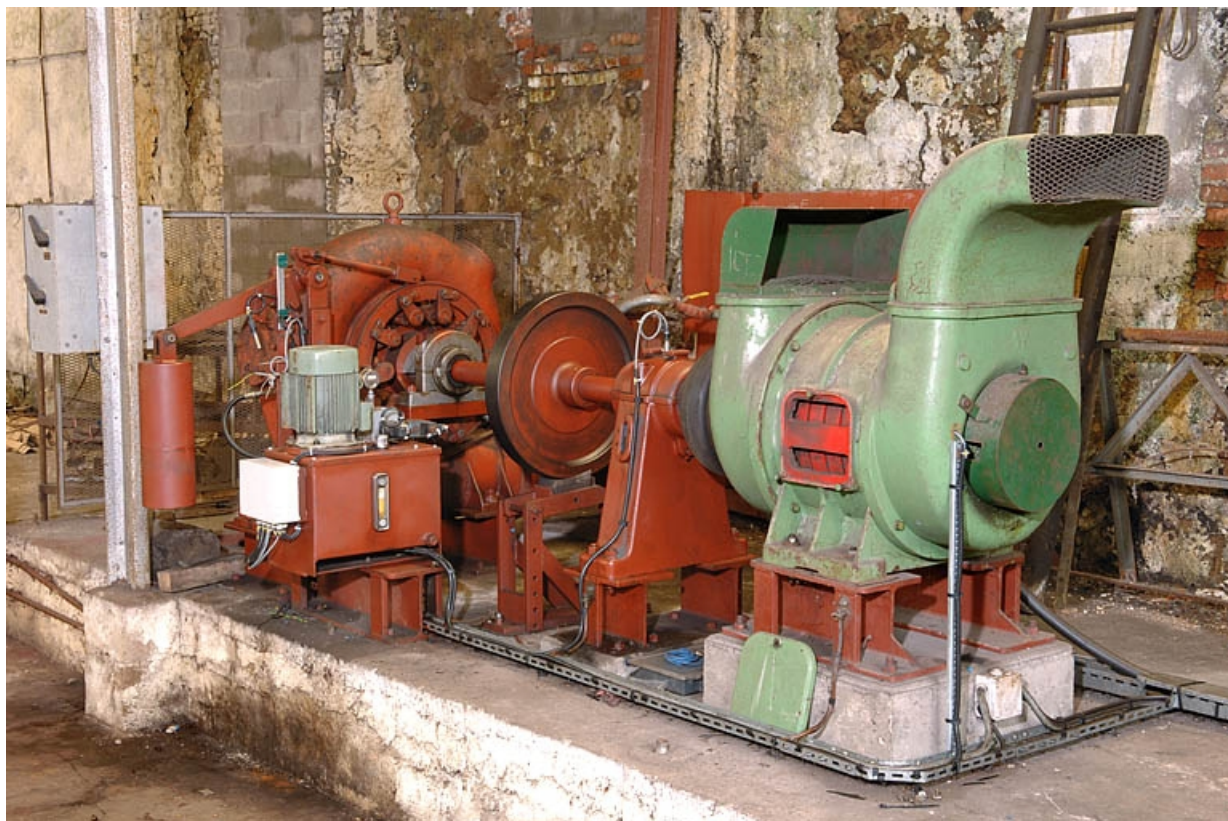
Atelier dit des Balanciers. Turbine et son alternateur.
