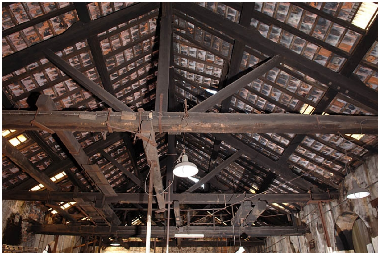
Charpente de la forge du Bas depuis le nord. 70, Corravillers R.D. 6, lieudit : Champs Fauvey
