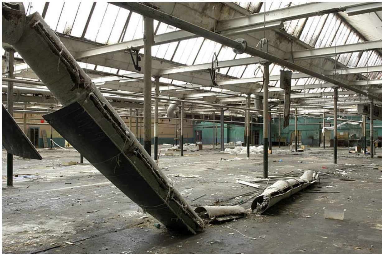
Extension est de la salle de tissage. Charpente métallique et sheds. 70, Héricourt, 5, 7 rue du 11 novembre
