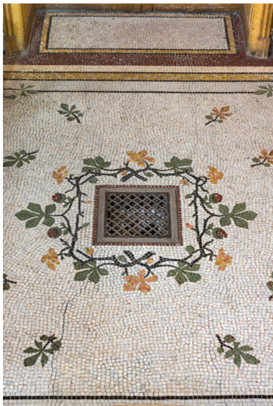
Vestibule du rez-de-chaussée, grille de chauffage au sol.
