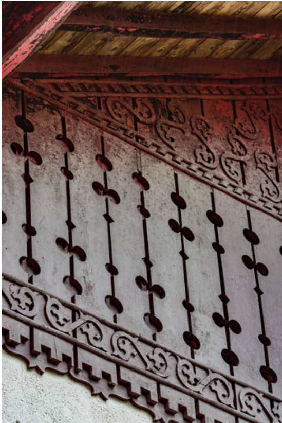
Placage de planches en bois ajourées et sculptées du pignon sous la saillie de rive. 58, Saint-Honoré-les-Bains, 12 avenue Jean Mermoz
