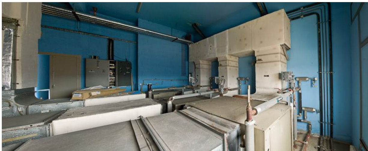
Bâtiment Maternité-Gynécologie (Gérontologie au moment de la prise de vue) : vue de la climatisation.
